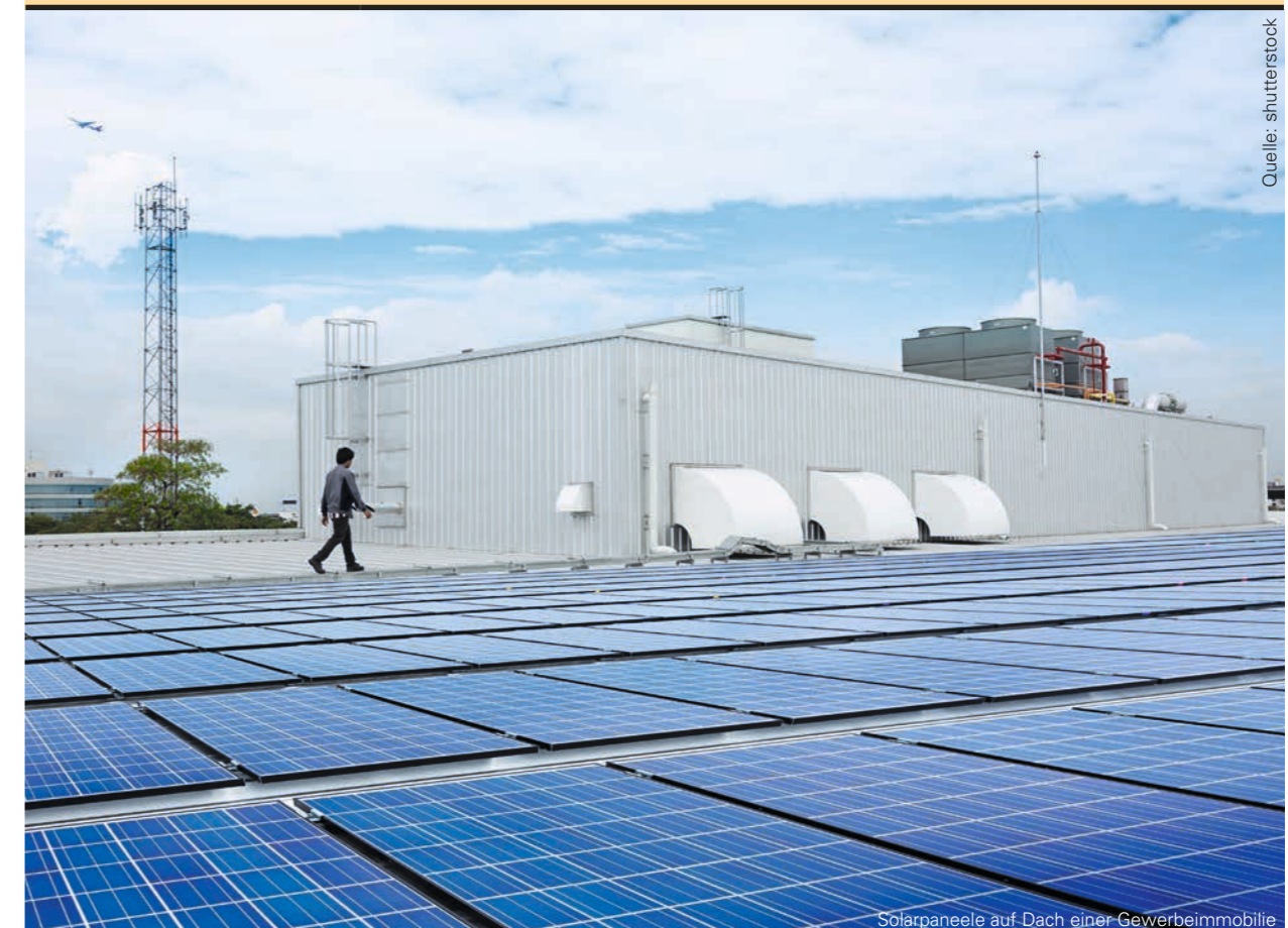
Solarpaneele auf Dach einer Gewerbeimmobilie
