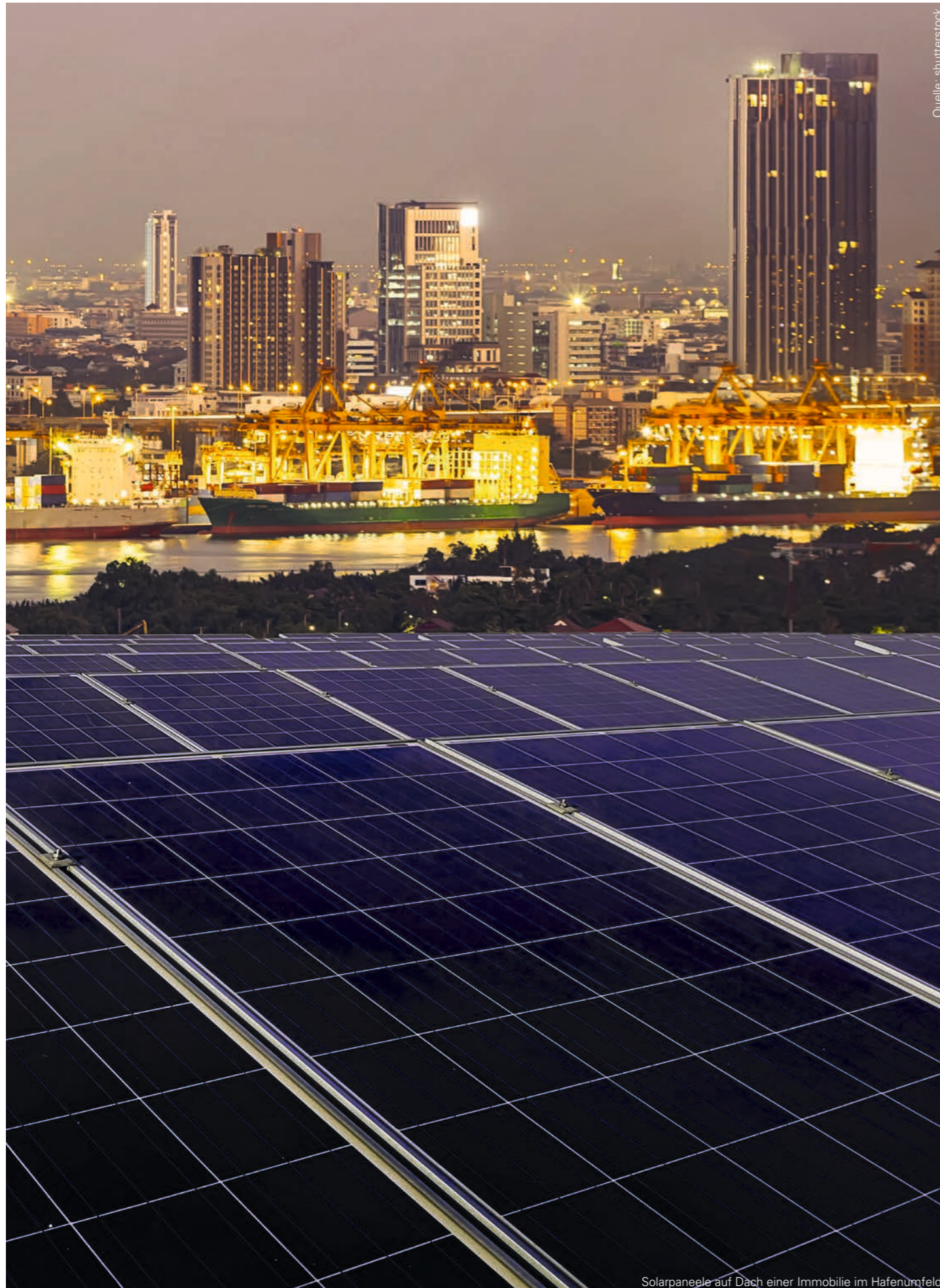
Solarpaneele auf Dach einer Immobilie im Hafenumfeld
